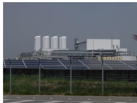
製造した水素のタンク
